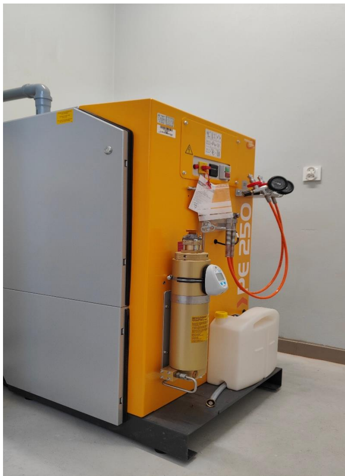
Fot. 32 Sprężarka w budynku warsztatowo-magazynowego JRG Nr 2 w Miastku
